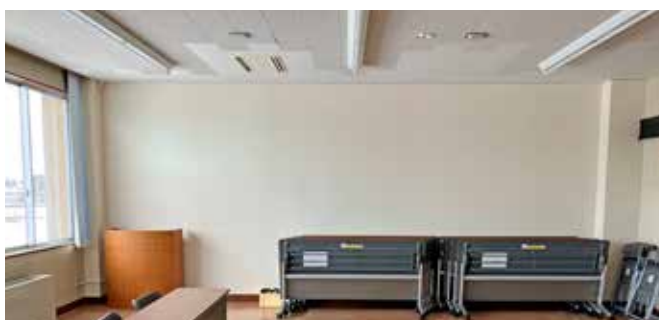
補修跡が残る視聴覚室
